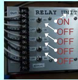
写真 4 リレーユニットの設定 (OUT チャンネル 1 のみ ON)
