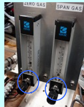
写真 6 ニードルバルブ付き流量計 (○ニードルバルブ)
